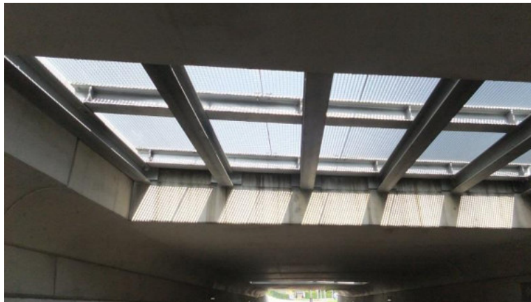
Abb. 40: Beispiel für die bauliche Ausführung einer natürlichen Beleuchtung in einer Unterführung für den Radverkehr
